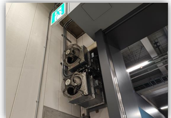
換気扇は各シャッターに設置 (接車側から撮影)
