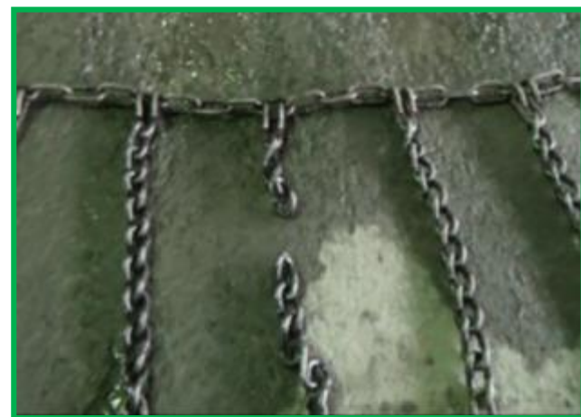
断裂した状態のチェーン
